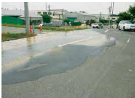
漏水が多発している中支線水路
